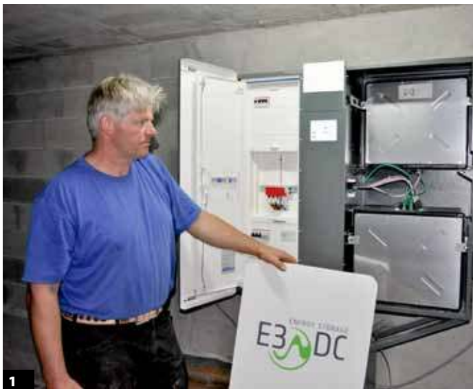
1 Das Hauskraftwerk lässt sich platzsparend im Haustechnikraum installieren. Es vereint die Batteriezellen und die Elektronik zur Steuerung der angeschlossenen Generatoren sowie der Verbraucherseite.
